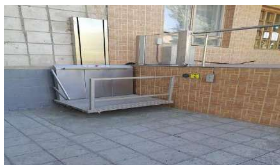
Пандус (наружный) подъемник
